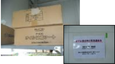
もしもの時の「オイル吸着マットと緊急連絡先」
